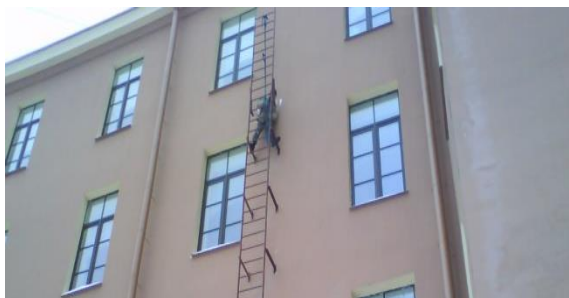
Рисунок 42. Спуск по стационарной настенной пожарной лестнице.
